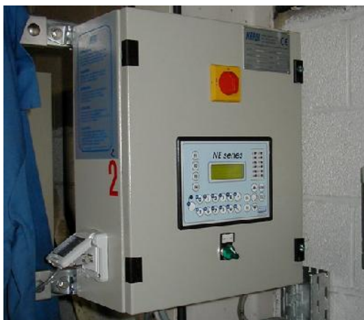
65 pav. Elektroninės kontrolės spinta
