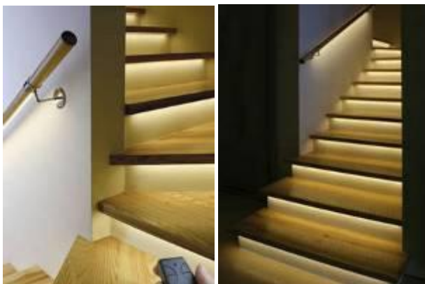
41 pav. Laiptų pakopų apšvietimas sukurtas, po kiekvieną pakopą montuojant profilį ir šaltos baltos spalvos šviesos diodų juostelę. Suvartojama 30W.
