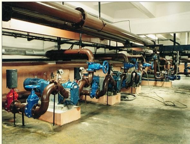
Rekonstruota „Vilniaus vandenių“ vandens ruošimo įranga.
