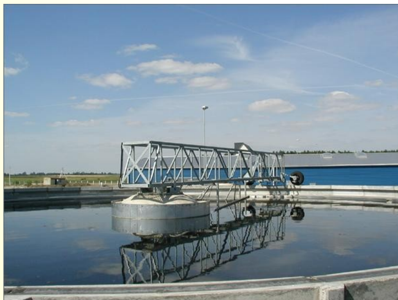
Rekonstruota Biržų vandens ruošimo įranga.
