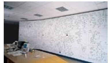
Pav.1 - Kaišiadorių ETS dispečerinis skydas
